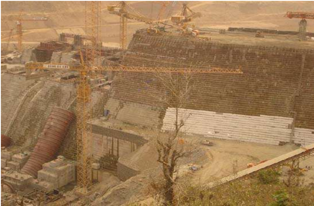
Chỗ tiếp giáp giữa phần nhà máy thủy điện (trái) và đập không tràn (phải)
